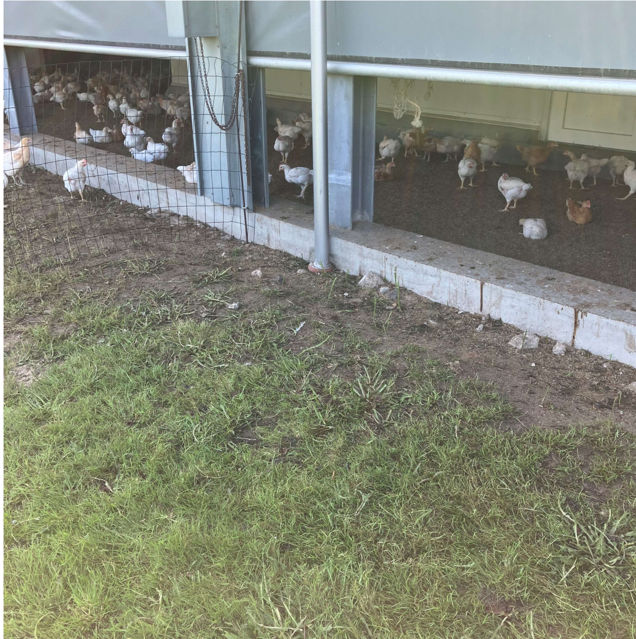
Hus 35: Manglende adskillelse i verandaen.
